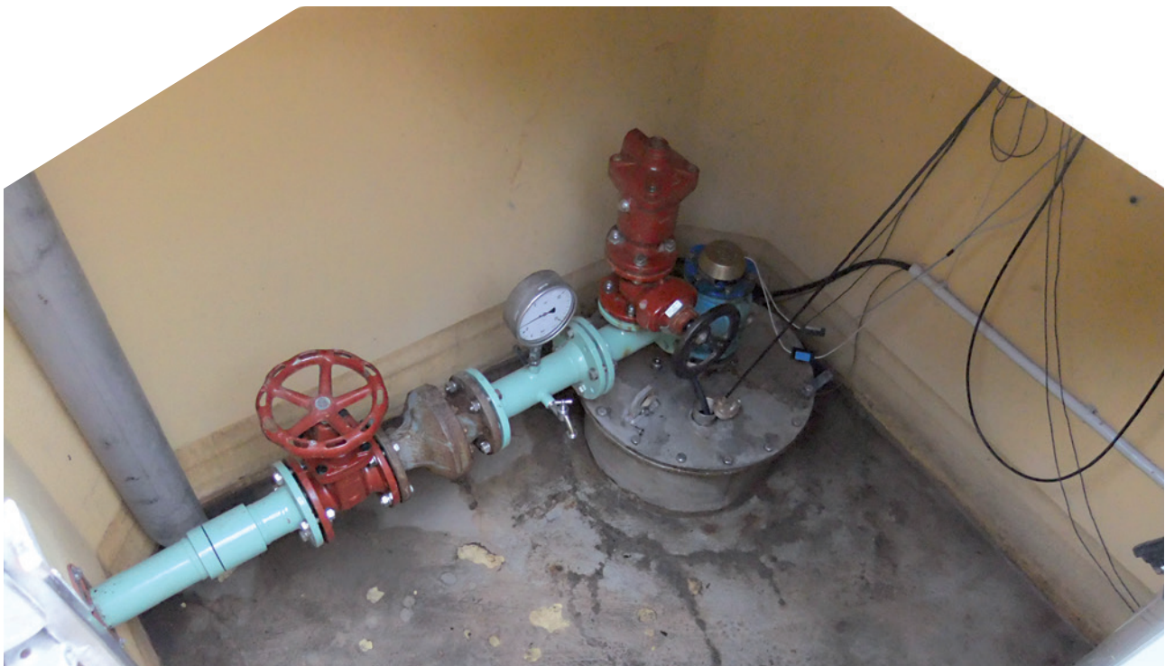
Brunnenstube des Zweckverbandes Wasser/Abwasser Bornaer Land (ZBL Borna). Quelle: G.E.O.S.
