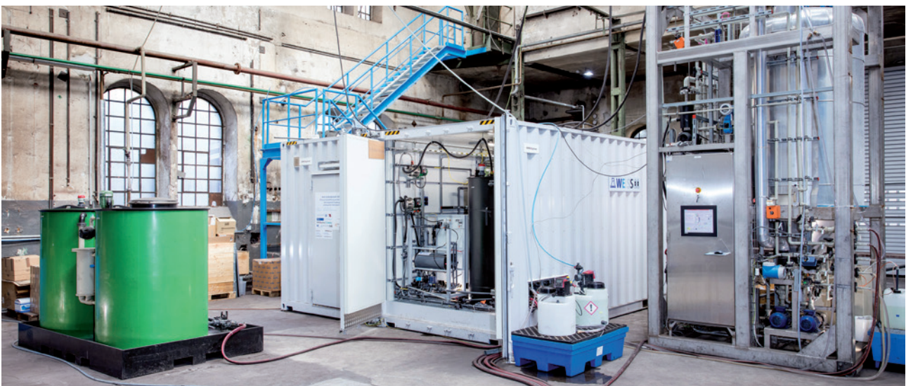
Mehrstufige Entsalzungsanlage aus WEISS (DEW, Hagen). Quelle: SMS group.
