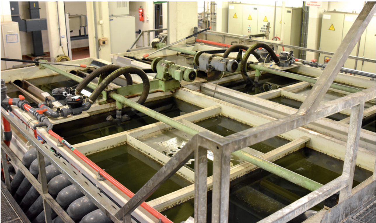
Aktuelle Abwasserbehandlungsanlage der Volkswagen AG am Standort Braunschweig mit einem Durchsatz von 150.000 m 3 pro Jahr. Quelle: Volkswagen AG.
